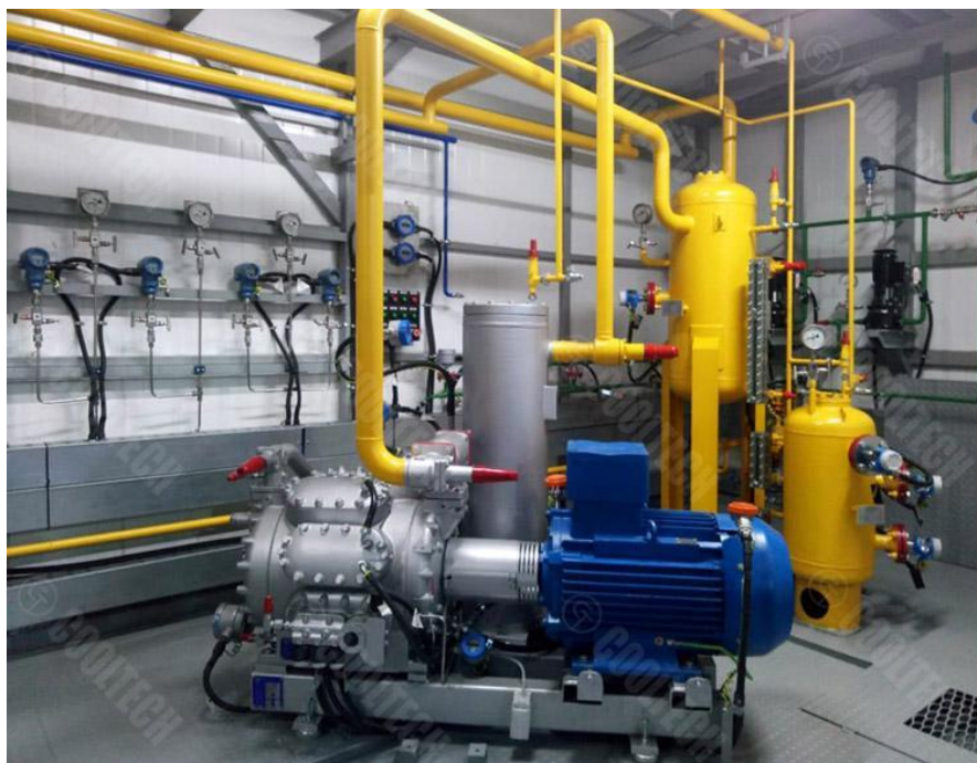
Рисунок 13 – Насосно-компрессорные установки (НКУ)
