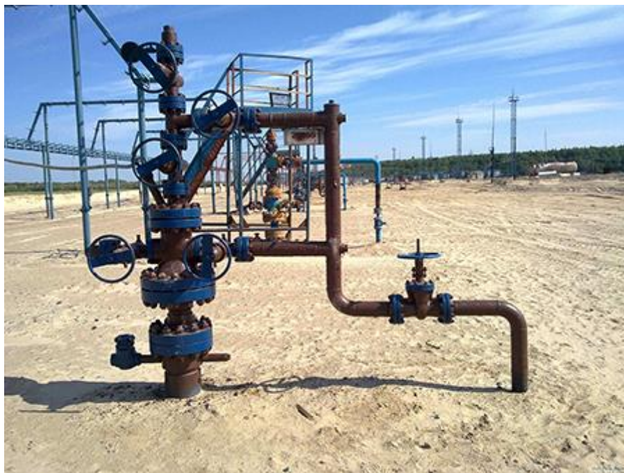
Рисунок 12 – Устьевое оборудование газлифта
